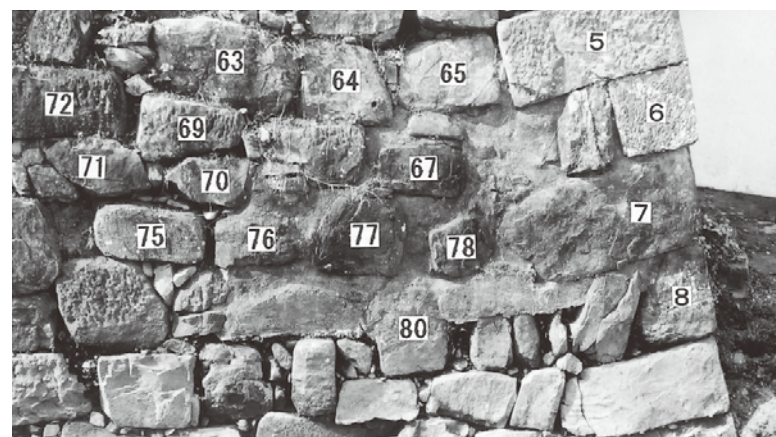
写真1 石垣A(東側)修復前(標高5.5~2.5m部分)
