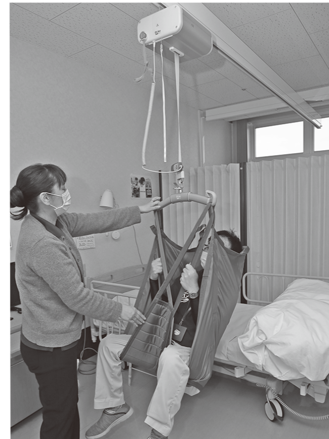
施設職員らによる新たに設置された「天井走行式リフト」の操作訓練
