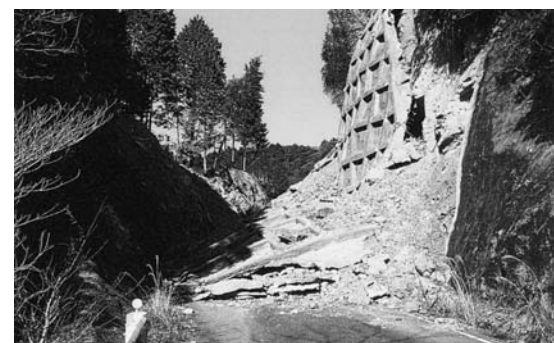
都呂々:杉ノ迫地区の地滑り状況
