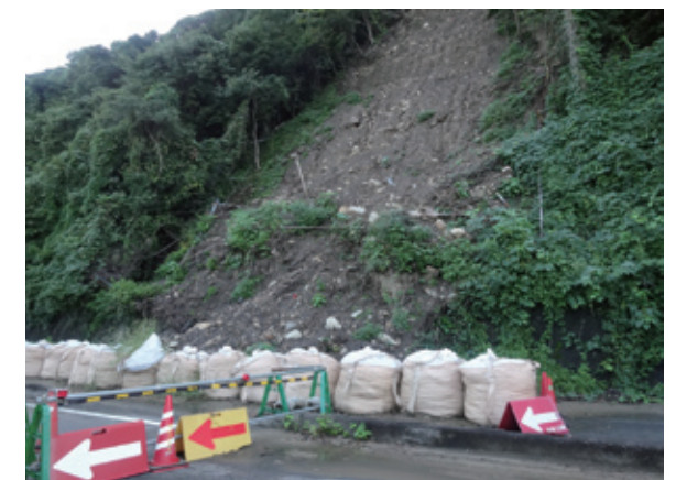
7月豪雨による被災状況(国道389号)
