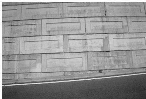
全体では、数十ヶ所の剥離修復跡が確認される
