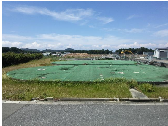
写真 2. オキシデーションディッチ槽
