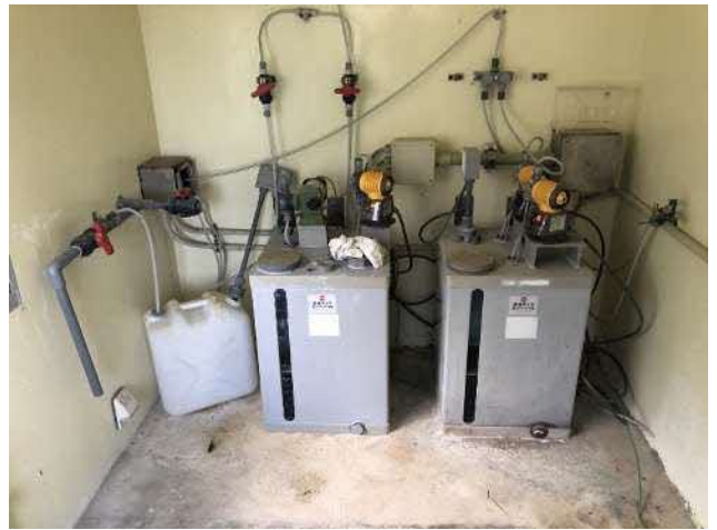
【 塩素注入設備 】
