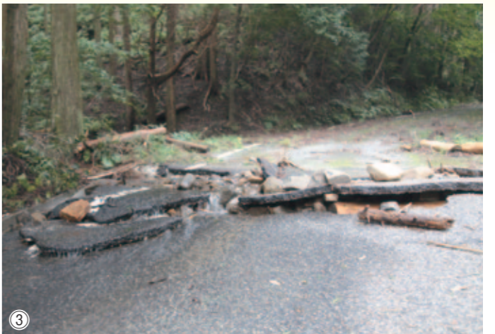
①町道赤仁田線(都呂々)の崩落現場 ②舞子川(都呂々)護岸の崩落 ③大雨でめくれたアスファルト(都呂々)
